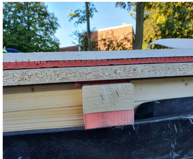
Vi ser en vibrasjonsdemper fastlimt på Posi-Joistens overgurt.
